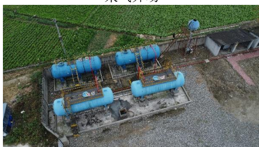
污水罐及围堰
